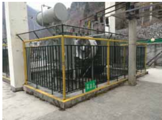
变压器机油坑
