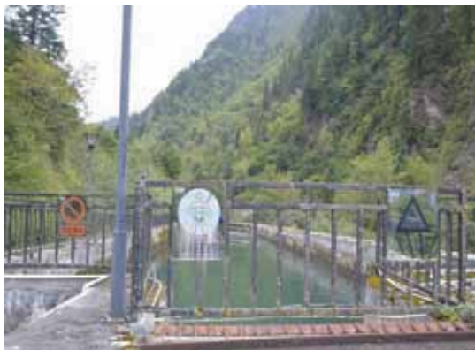
沉沙池护栏及警示标牌
