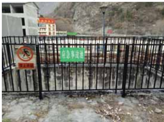
升压站事故应急池
