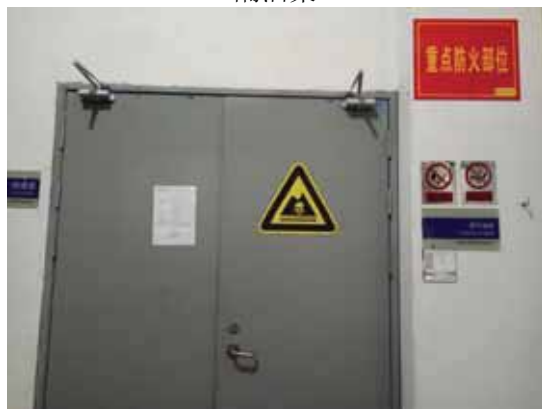
透平油库、危废暂存间防火门
