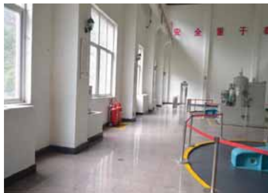
厂区消防设施
