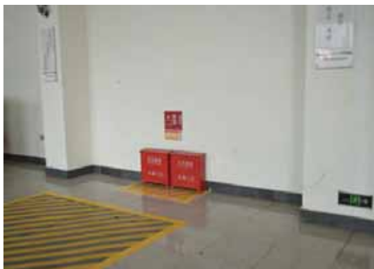
厂区消防设施
