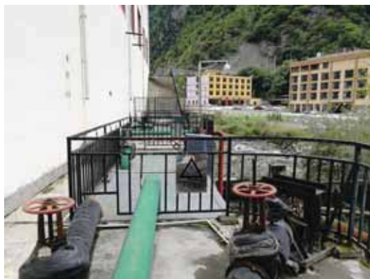
尾水渠护栏及警示牌
